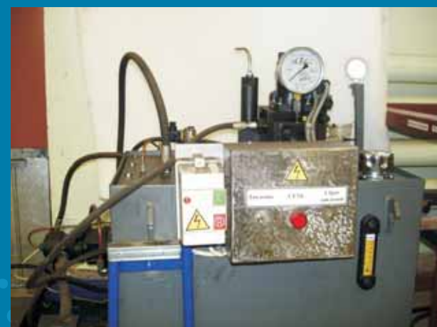
Гидростанция высокого давления
