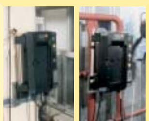
Контроль топливосжигающего оборудования одной системой
