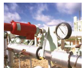
Газовая инженерия: Влажность вызывает повреждения и уменьшает ценность газа в системе
